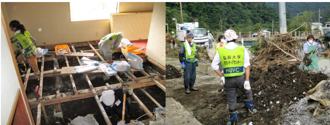
作業がほぼ終わった床下と積み上げられた泥
